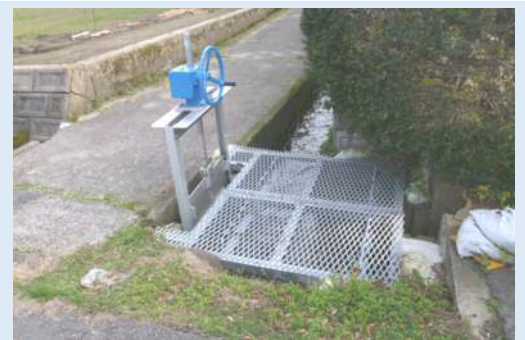
長寿命で更新したスライドゲート
